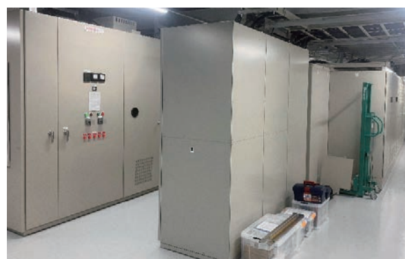
写真1 R階電気室の様子
