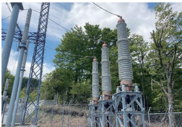
写真15 110kVケーブル気中端末
