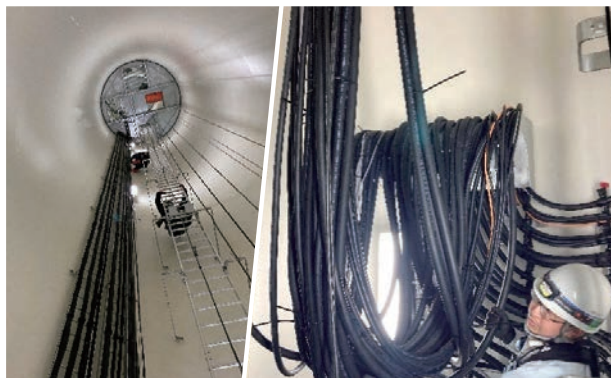
写真10 風車タワー内部昇降
