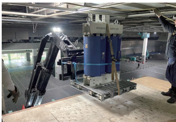
写真2 格子天井と搬入物の状況
