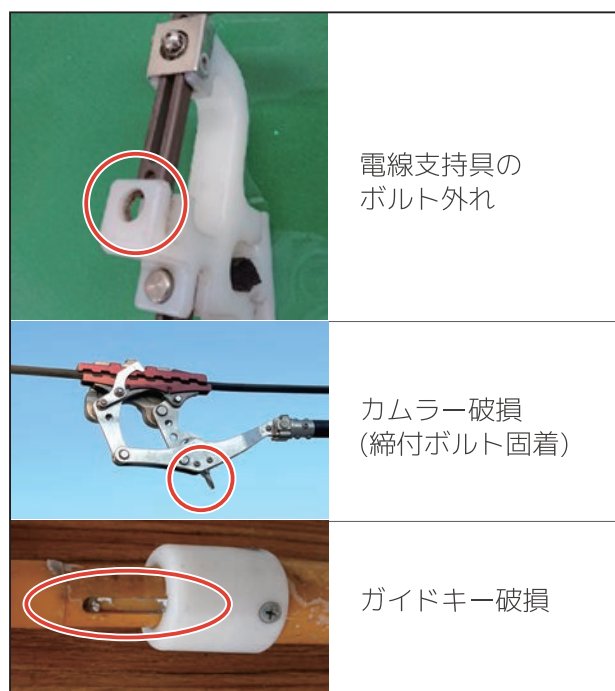
【写真3】 主な破損状態
