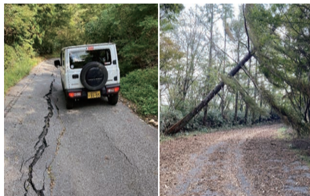
写真5 台風による特高機器搬入路損壊
