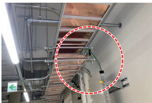
写真4 銅板とIV電線の半田接続状況（2） （垂直ケーブルラックのIV電線と 水平ケーブルラック上の銅板の接続）
