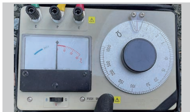
写真6 統合接地極の接地測定状況(0.2Ω)
