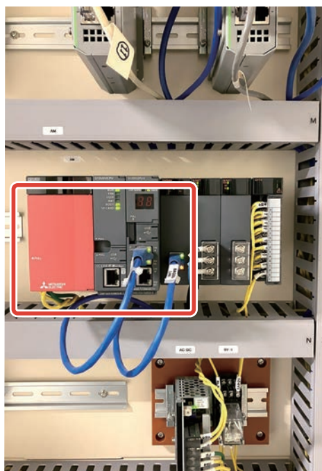
写真1 統合検針 コントローラーユニット
