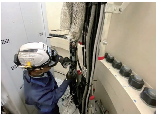
写真12 風車タワー接合部 ケーブル接続
