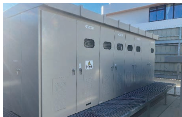
写真2 分散化を行った5階電気室
