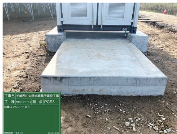
写真5 中間変電設備（対策後）
