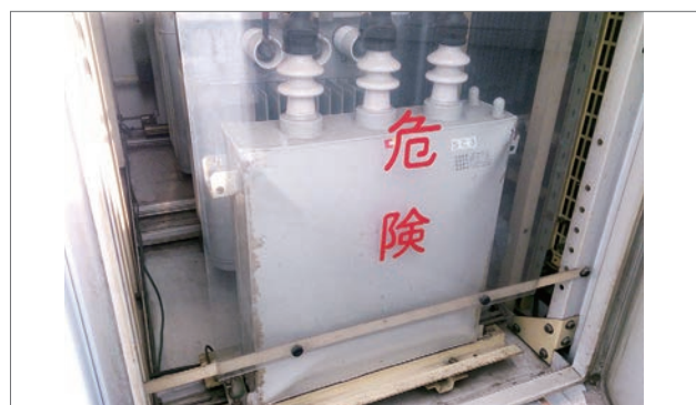
写真 1 進相コンデンサの損傷状況
