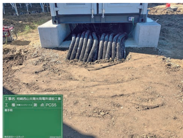
写真4 中間変電設備（対策前）
