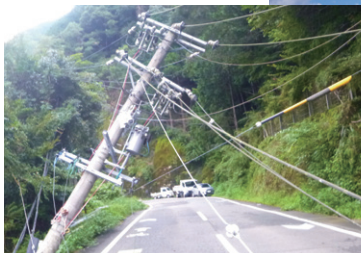
◀ 土砂崩れにより傾いた電柱 (台風15号)
