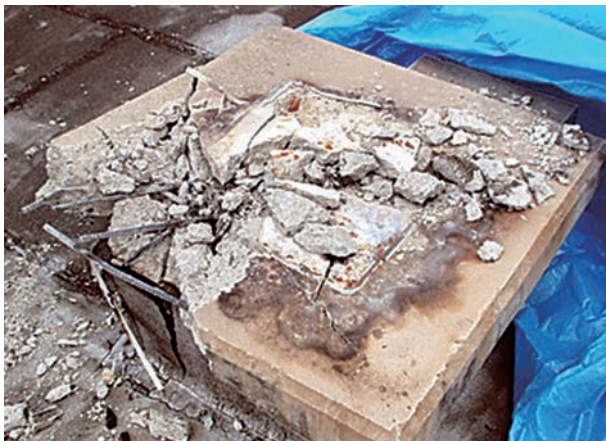
図 21 直撃雷により倒壊した避雷針
