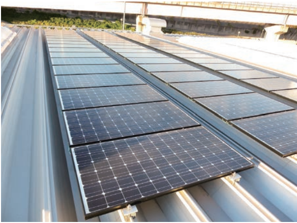
写真2 折板屋根のPV設置状況
