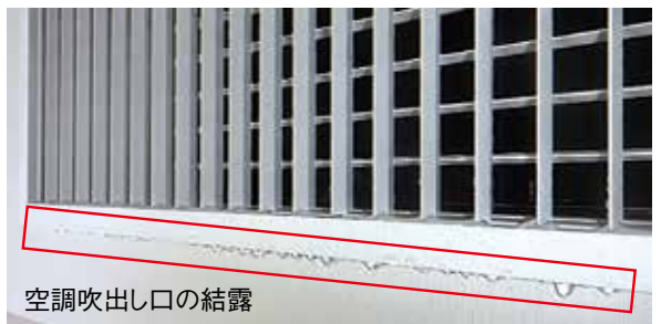
写真5 空調吹出し口の結露
