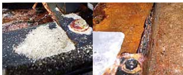
(a)塩の堆積 (b)ドレンパンの腐食
