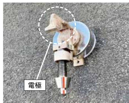
写真6 ケーブル分岐金具程
