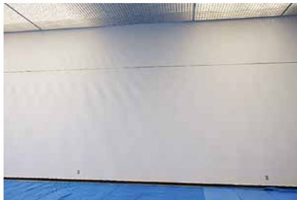
写真7 壁面に光影が発生した状況
