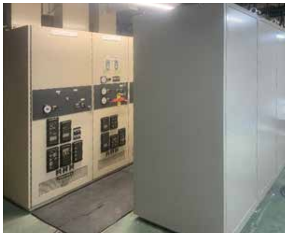
写真2 低圧饋電盤（既設）、高圧饋電盤（新設）
