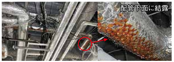
写真4 既設棟ラウンジの天井内配管の結露
