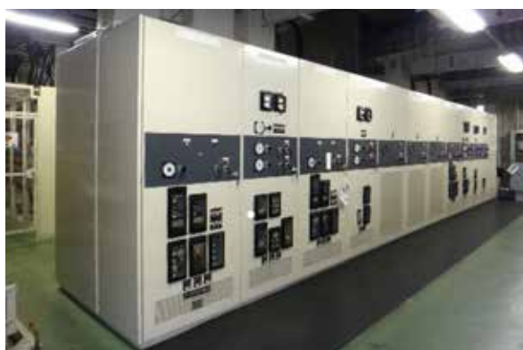
写真1 低圧饋電盤（既設）
