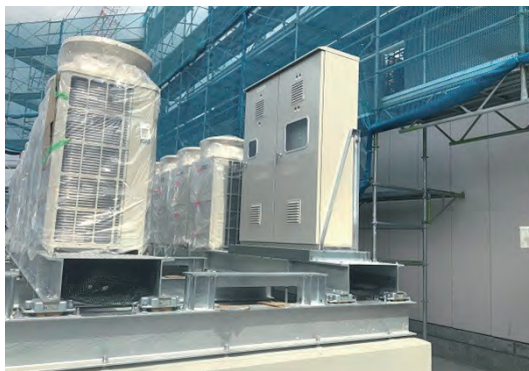
写真1 室外機ユニットと動力盤
