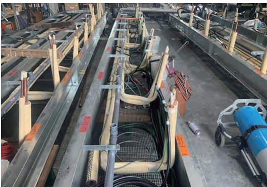
写真3 配線スペース
