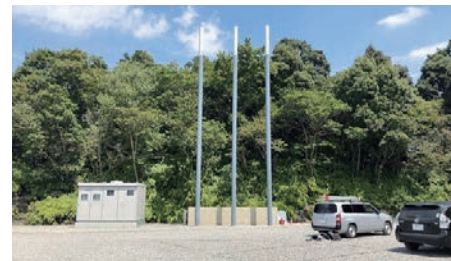
▲VISON内に設置した携帯電話用アンテナ設備
