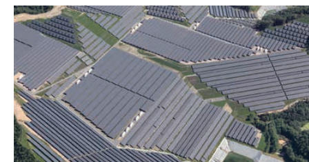
トーエネック福島本宮太陽光発電所
