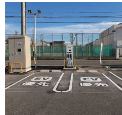
電気自動車(EV)用充電設備
