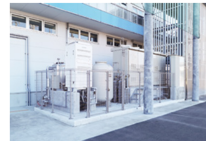
CO 2 フリー水素製造システム(安全創造館)
