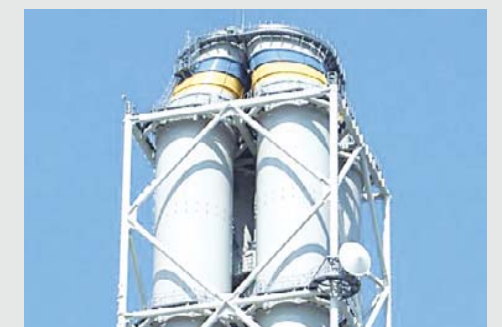
集合煙突上部架台に設置された「多重無線パラボラアンテナ」
