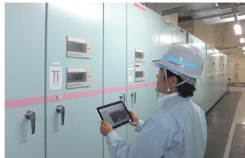
タブレットによる状態監視
