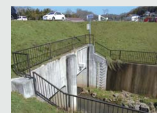
システム外観(上流側)
