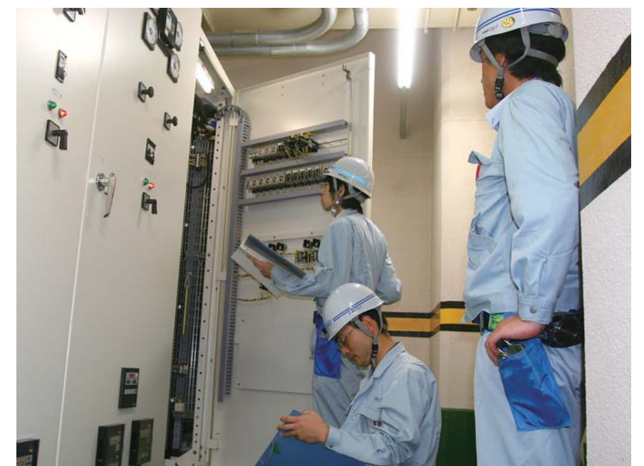
電気室の設備点検
