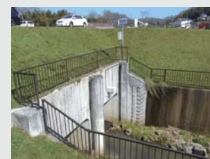
システム外観(上流側)
