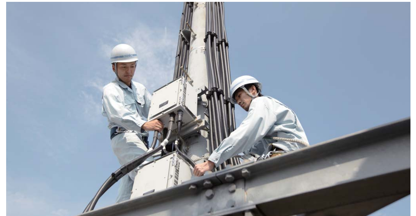
移動体通信基地局の確認作業
