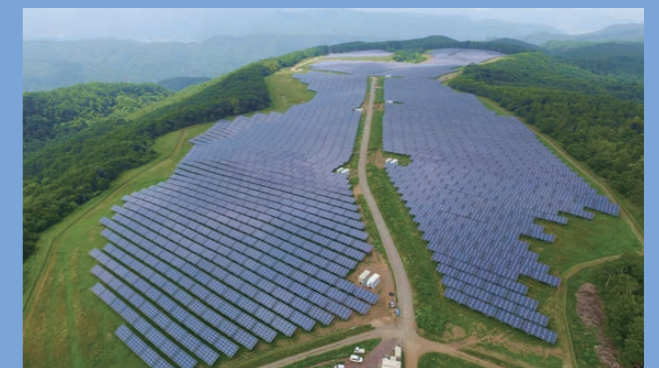
長門牧場メガソーラー発電所
