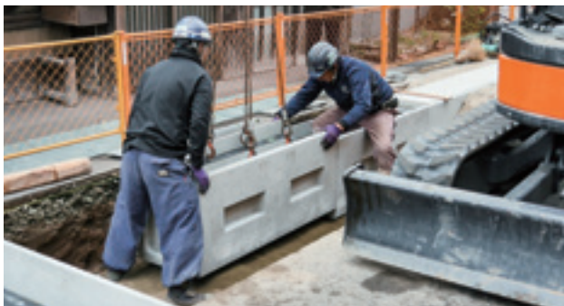
△小型ボックス設置の様子
