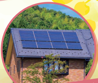
太陽光発電/蓄電池
